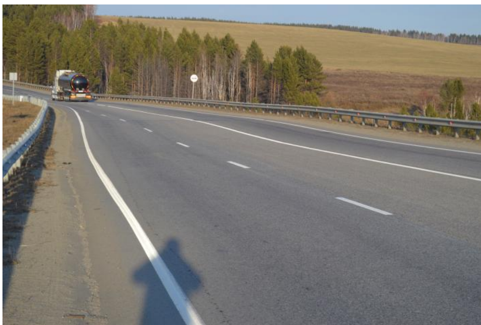
Рис. 1. Участок деформации дорожного полотна / Fig. 1. Section of roadbed deformation
